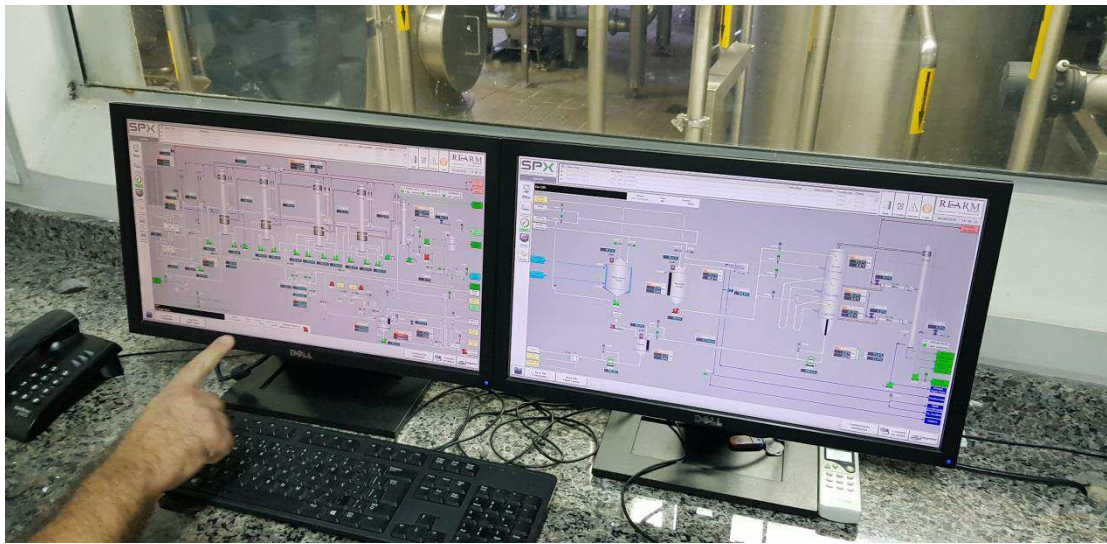
Controle de produção automatizado leite condensado
