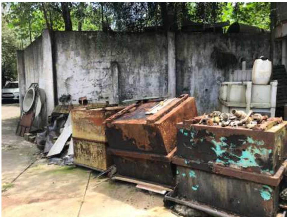
Foto 19 - Detalhe do muro de contenção da área frontal preparada para futura ampliação.
