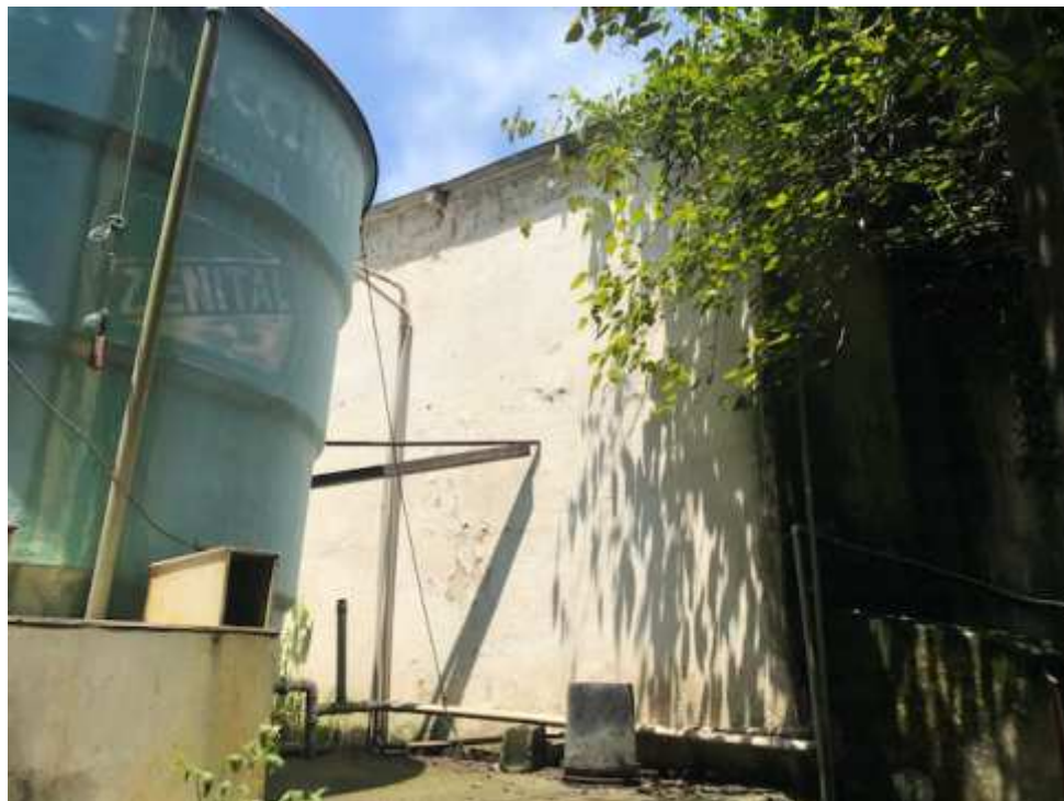
Foto 17 – Detalhe dos reservatórios de água – reuso e incêndio.
