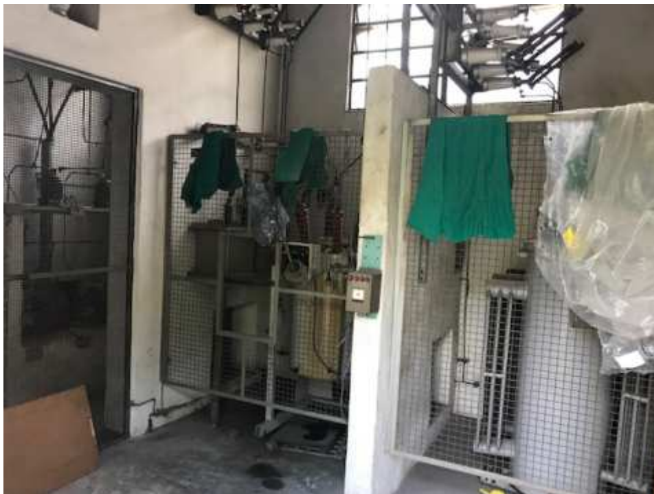
Foto 21 - Vista interna da cabine primária, com entrada trifásica.
