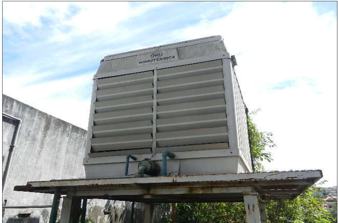
1.009 – VISTA DA TORRE DE RESFRIAMENTO MARCA: HIDROTERMICA
