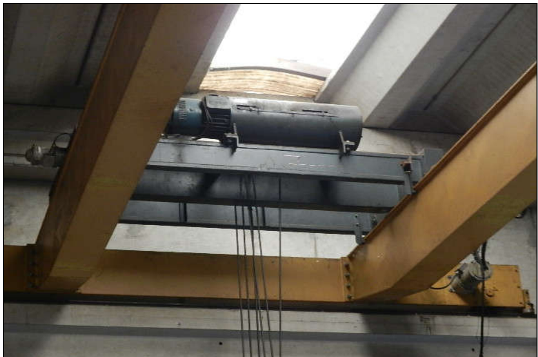
3,005 – VISTA DA PONTE ROLANTE MARCA: VASTEC CAP: 15 TON
