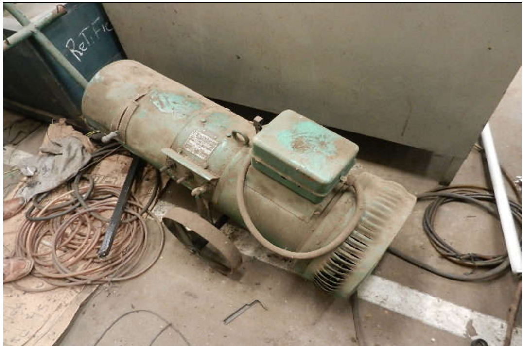
1.007 – VISTA DO GERADOR DE SOLDA MARCA: BAMBOZZI MODELO: TN-3B-45
