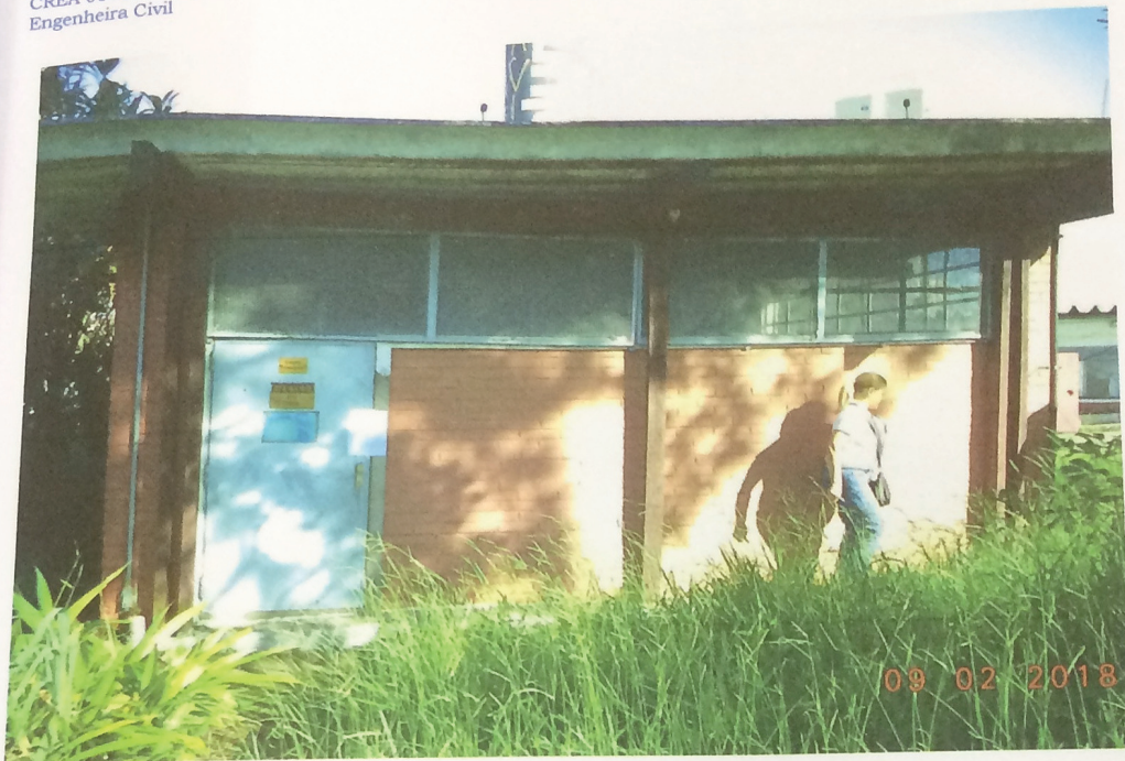
Foto 40 - Prédio 6 - Entrada Cabine de Força
