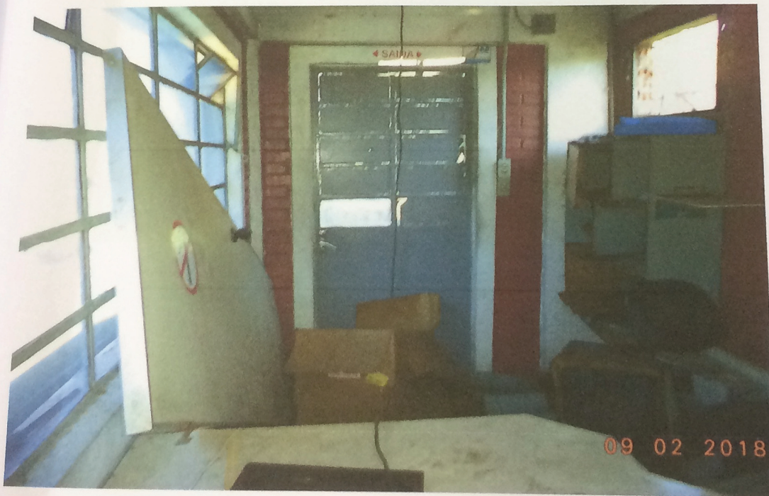
Foto 43 - Prédio 8 - Controle de Balança .
