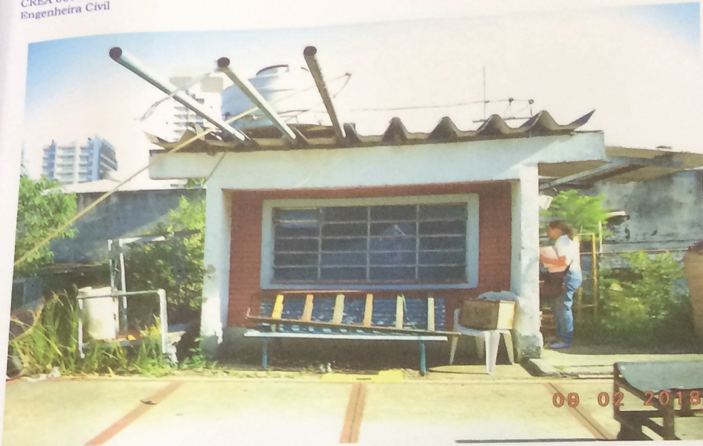
Foto 42 - Prédio 8 - Controle de Balança
