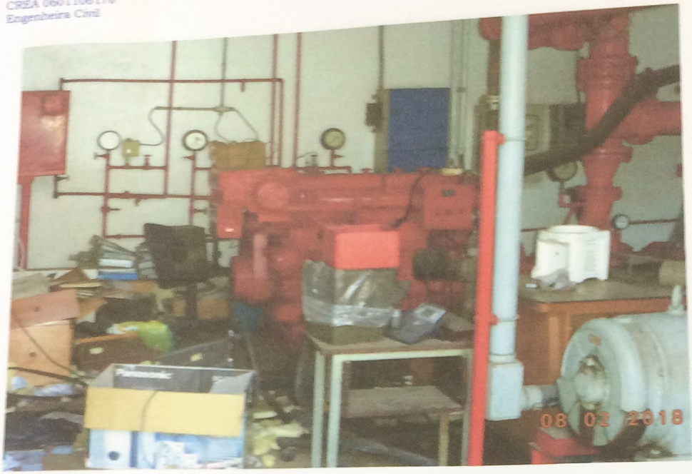
Foto 53 - Prédio 11 - Interior da Casa de Bombas
