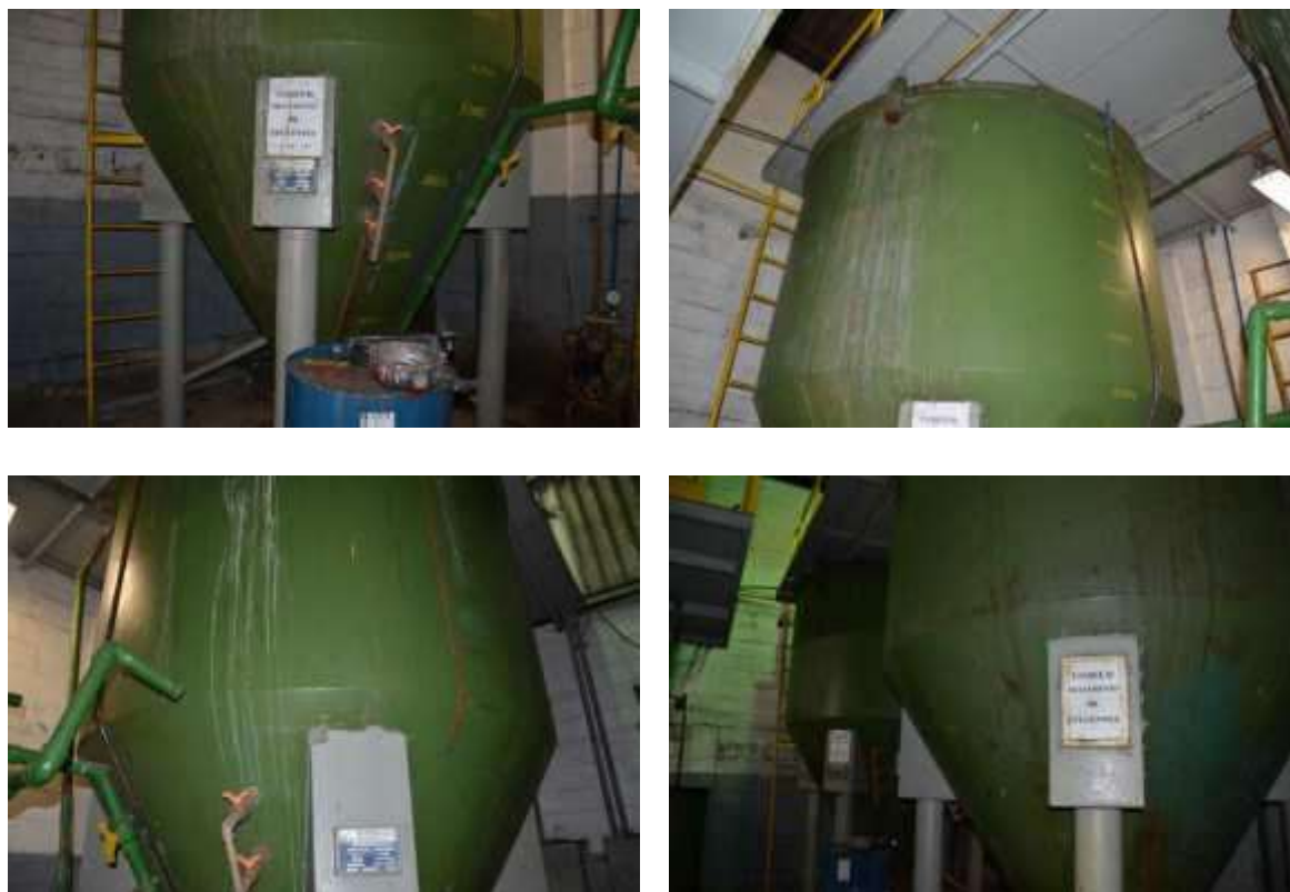
FIGURA 57 - SISTEMA DE TRATAMENTO DE EFLUENTES DE PINTURA
