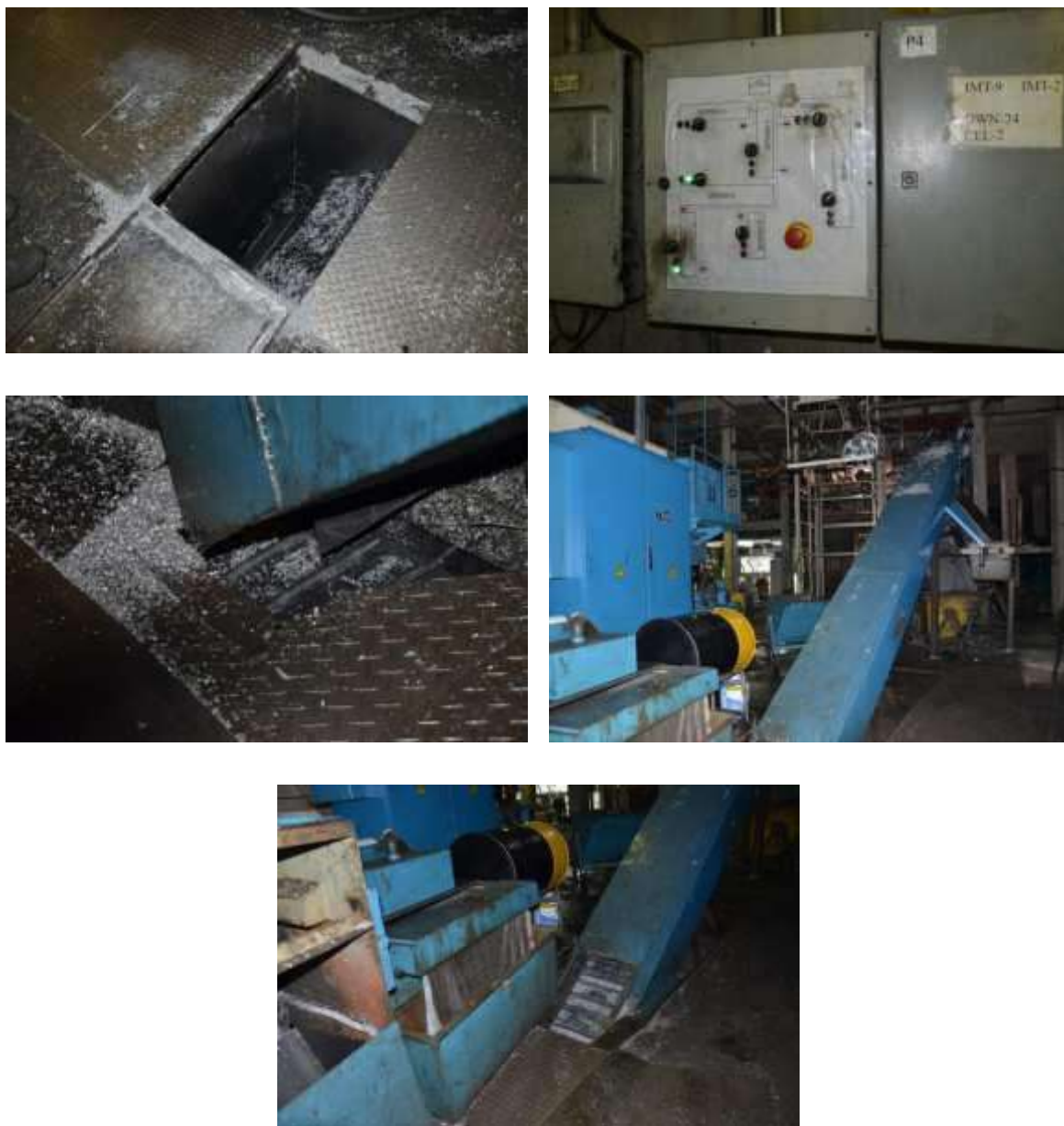
FIGURA 47 - SISTEMA DE ESTEIRAS MOTORIZADAS PARA COLETA DE CAVACOS DE USINAGEM
