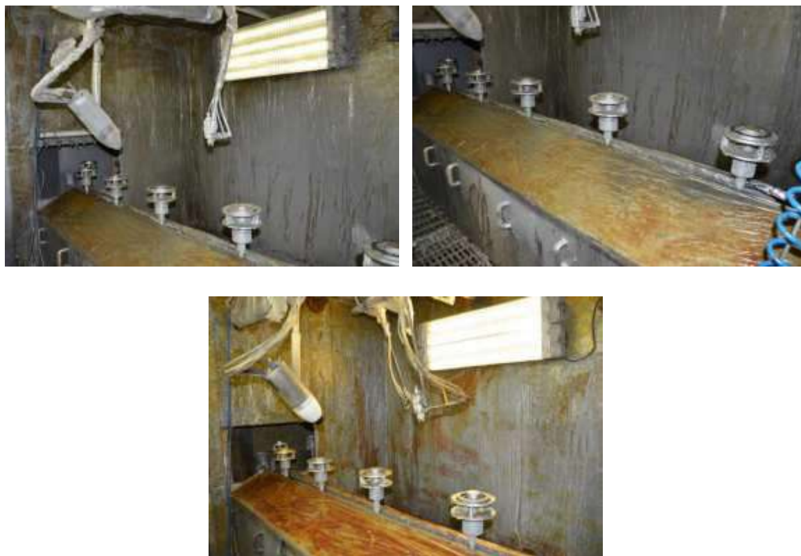
FIGURA 61 - CABINE DE PINTURA LIQUIDA E VERNIZ
