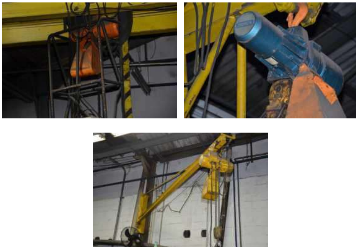
FIGURA 14 - TALHAS ELÉTRICAS E PONTE ROLANTE
