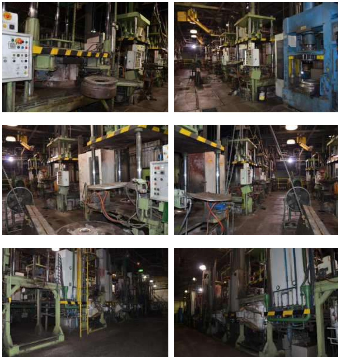
FIGURA 41 - ILHA DE FUNDIÇÃO (1) (2) (3) COM 04 INJETORAS, PAINÉIS, FORNO E CENTRAL HIDRÁULICA
