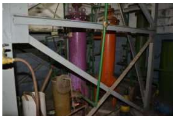
FIGURA 58 - ESTAÇÃO DE ÁGUA DEIONIZADA
