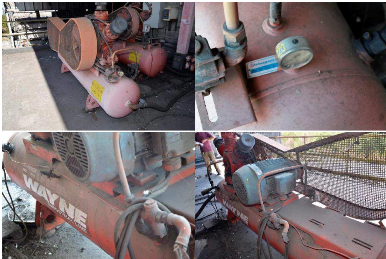
FIGURA 27- COMPRESSOR DE AR COMPRIMIDO WAYNE INDUSTRIAL LINE - MODELO W2-912012H - 460L - 30HP - TAG 23VP02 - PRESSÃO DE TRABALHO 8,0 KGF/CM2
