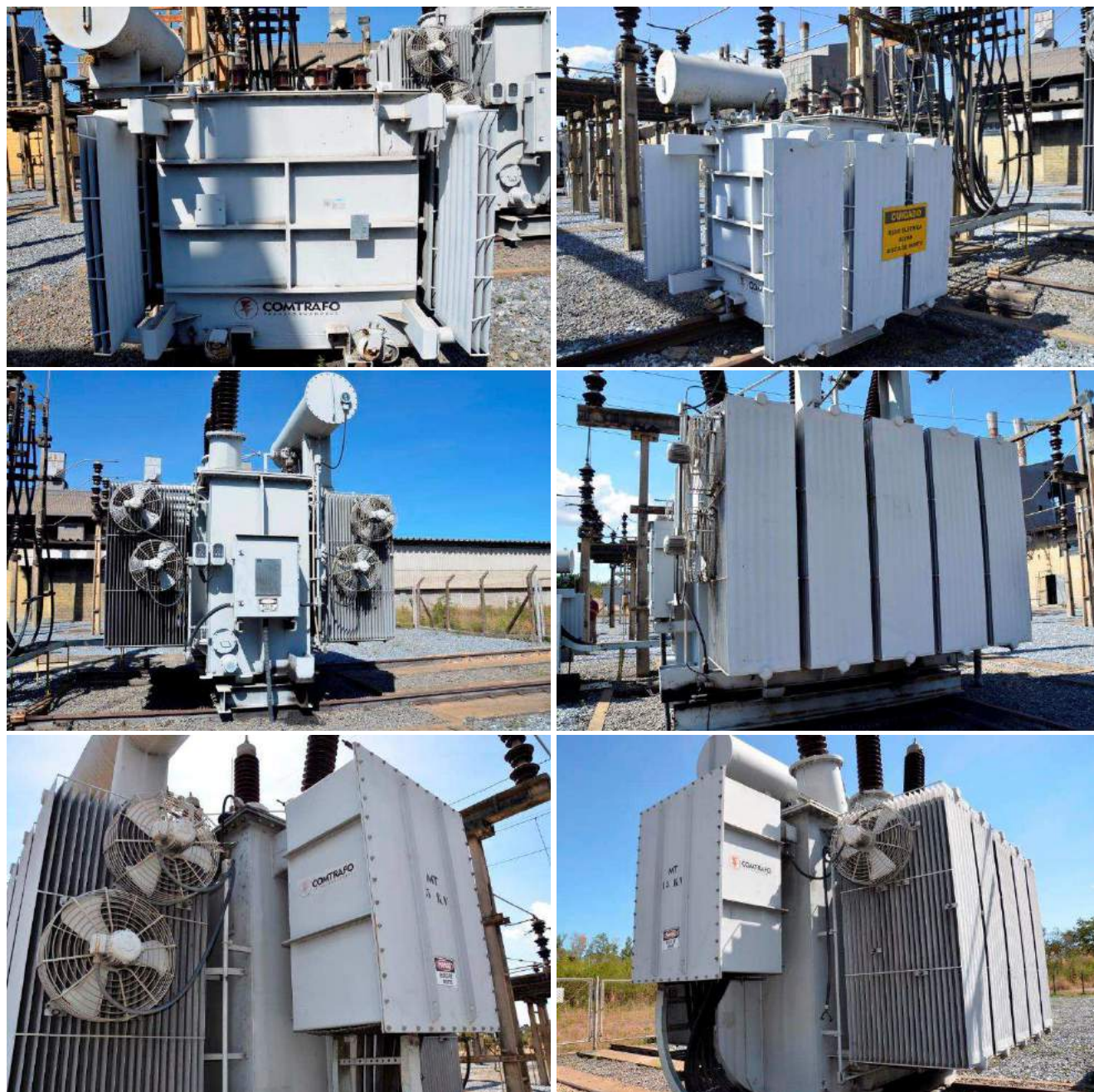
FIGURA 26 - TRANSFORMADOR SUBESTRACAO 1500KVA 15 KV NUMERO DE SERIE 044345
