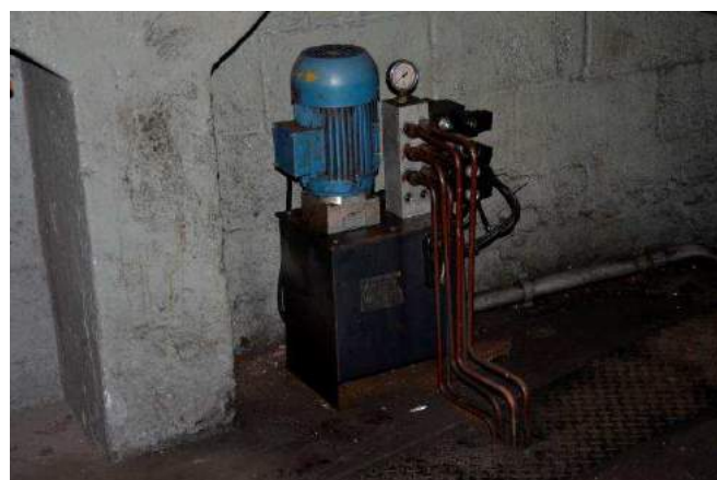
FIGURA 53 - SISTEMA HIDRAULICO PARA TRATAMENTO DE RODAS
