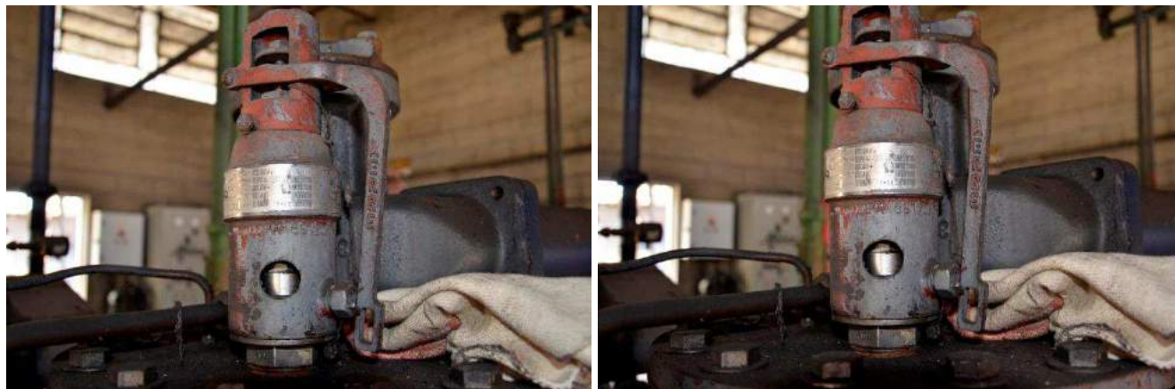
FIGURA 19 - COMPRESSOR ATLAS COPCO
