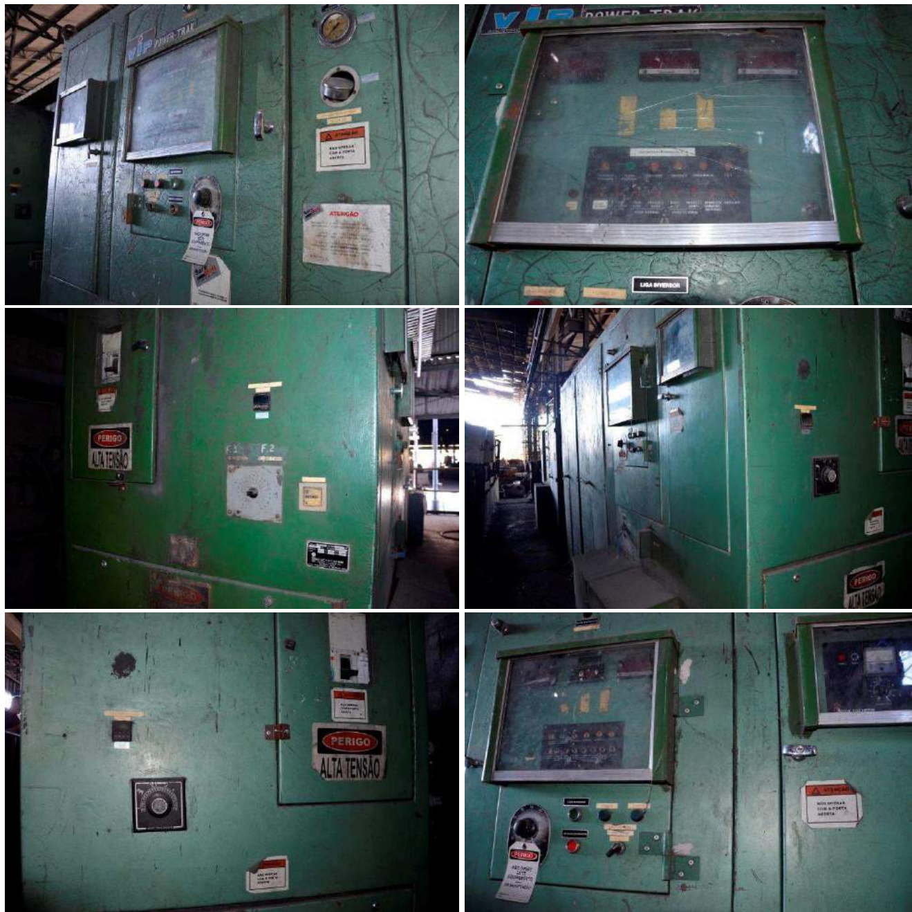
FIGURA 15 - FORNO INDUCTOTERM DE FUSÃO COM POSTO DE TRANS. T MODELO VIP PT5 - R, FORNO DE FUSÃO INDUCTOTHERM ST, CABINE INDUTOTERM VIP POWER - POT NORMAL
