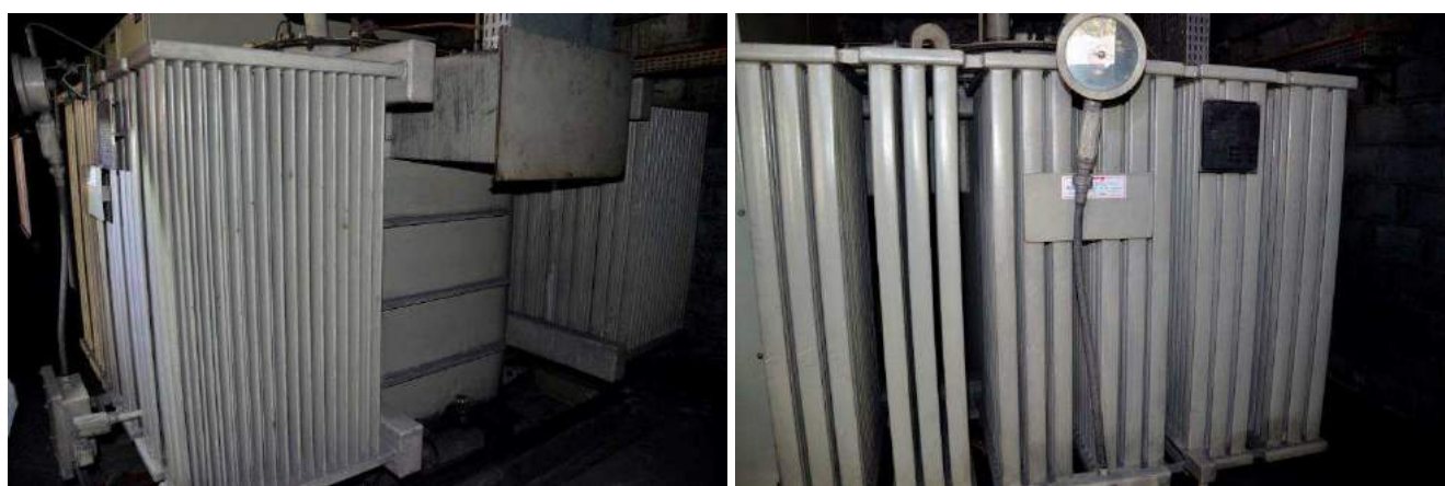
FIGURA 13 - TRANSFORMADOR DENSITEL - 1250 KVA - 3 FASES - 60Hz - A OLEO - 13,8 KV
