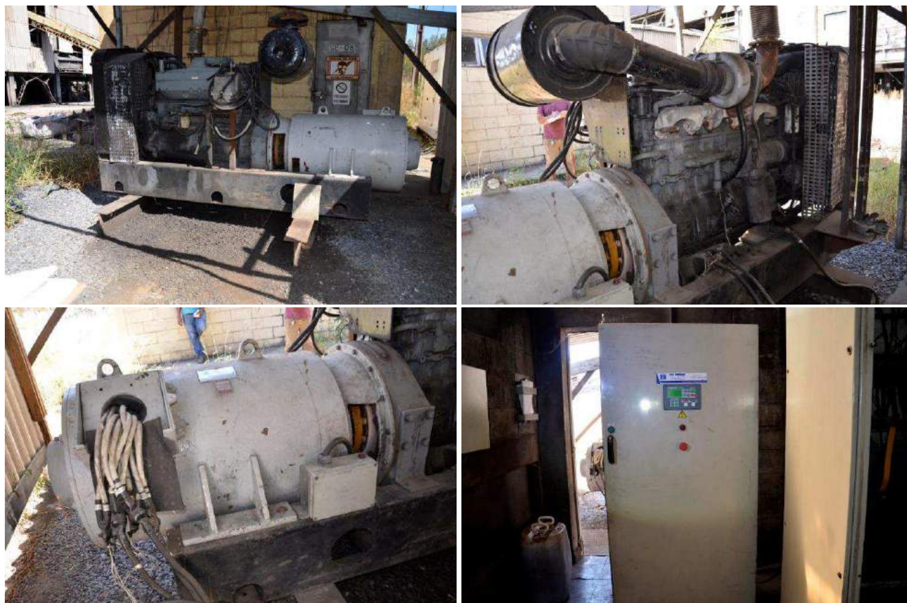
FIGURA 25 - GRUPO GERADOR - MITSUBA - NEGRYNY - MOTOR DE INDUÇÃO TRIFÁSICO - MODELO ATX - 60Hz - 325 KVA - 1300 RPM
