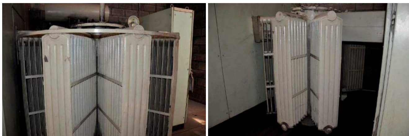
FIGURA 373 – TRANSFORMADOR DE ALTA TENSÃO 500KVA
