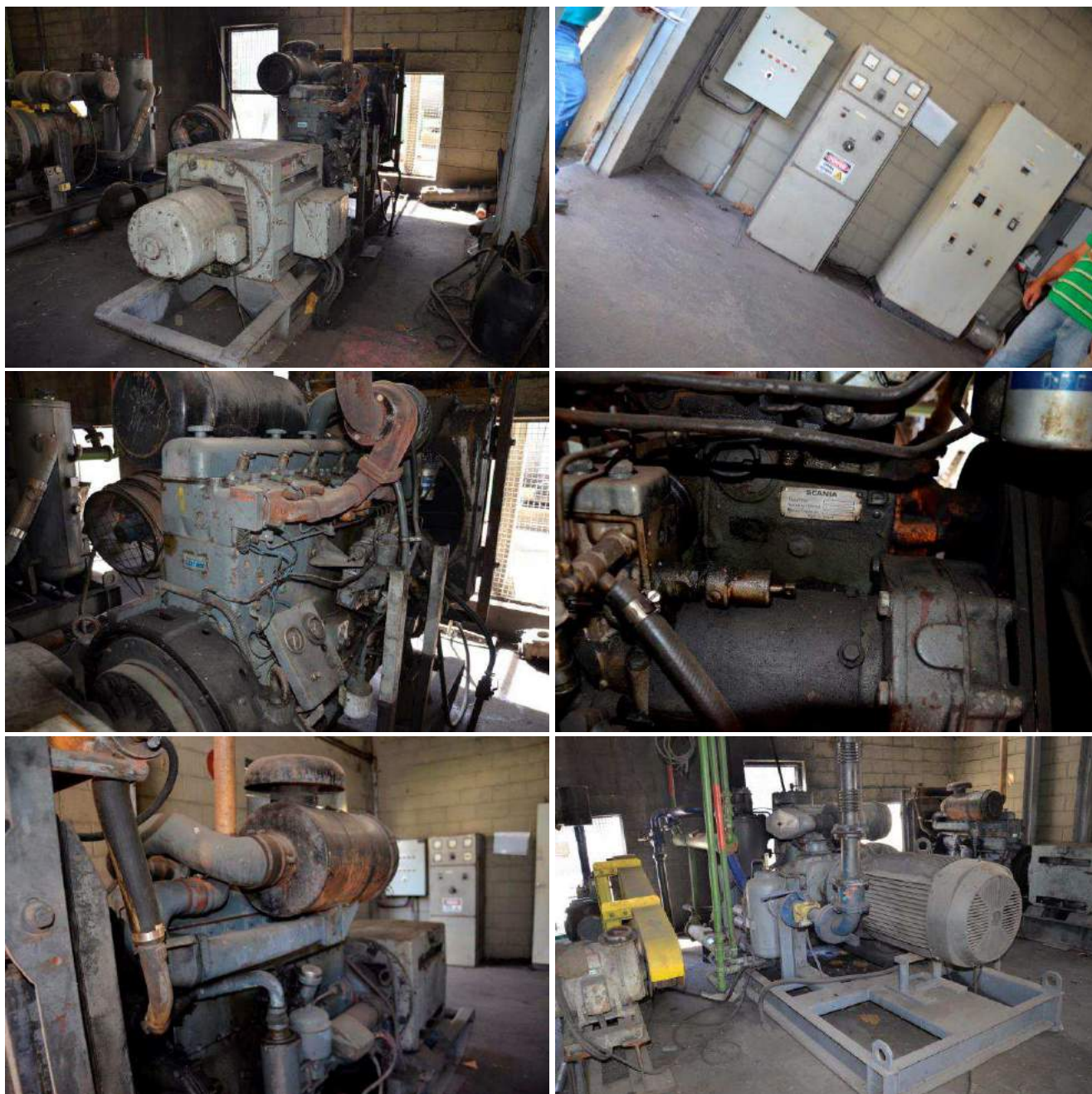
FIGURA 18 - GRUPO GERADOR TOSHIBA ICNE 737 KVA A 900 RAM - 220/380/440, COM MOTOR DIESEL MARCA MWM - TBD 440 850 HP A 900 RPM - 06 CILINDROS, TURBO, INTERCOOLER - COM QUADRO DE COMANDO E REGULADOR DE TENSÃO - ANO DE FABRICAÇÃO 1970
