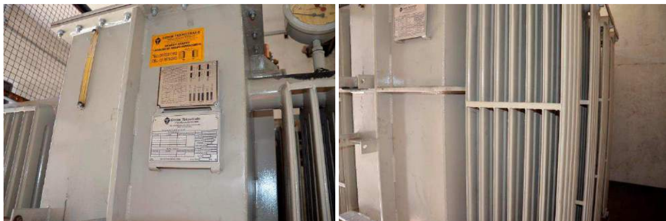
FIGURA 351 - TRANSFORMADOR DE ALTA TENSÃO 600KVA
