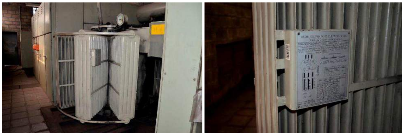
FIGURA 362 – TRANSFORMADOR DE ALTA TENSÃO 1000KVA
