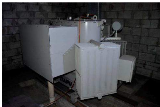
FIGURA 11 - TRANSFORMADOR DE ISOLAÇÃO TRIFÁSICO 350KVA – ITAIPU
