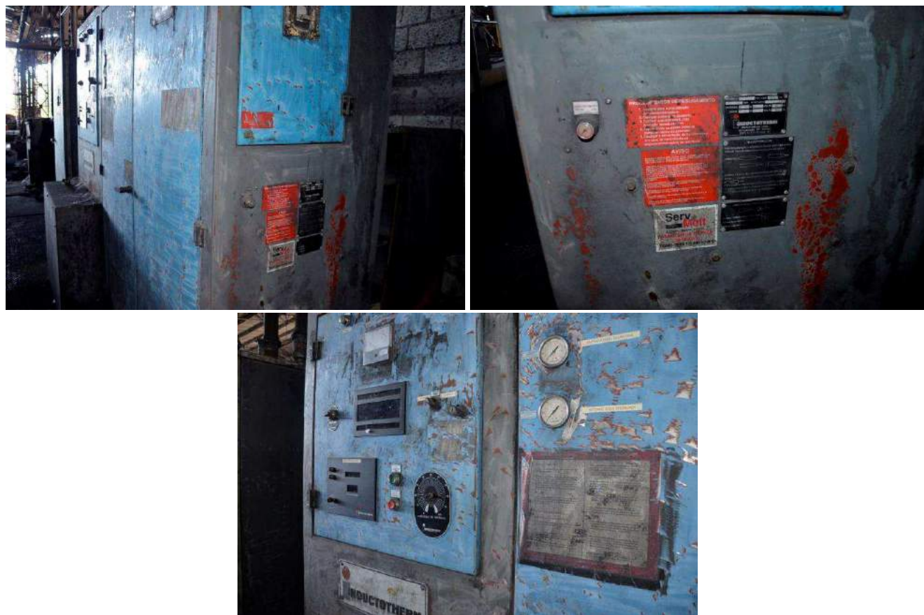
FIGURA 16 - FORNO INDUCTOTERM DE FUSÃO COM POSTO DE TRANS. T MODELO VIP PT5 - R, FORNO DE FUSÃO INDUCTOTHERM ST, CABINE INDUTOTERM VIP POWER - POT NORMAL
