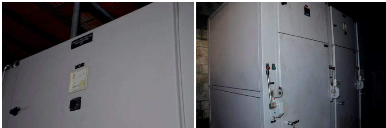
FIGURA 12 - CUBÍCULO DE MÉDIA TENSÃO
