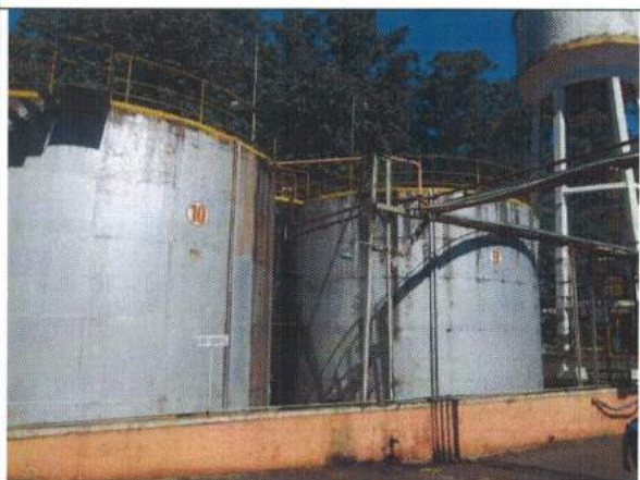
12 – Tanques para óleo (51)
