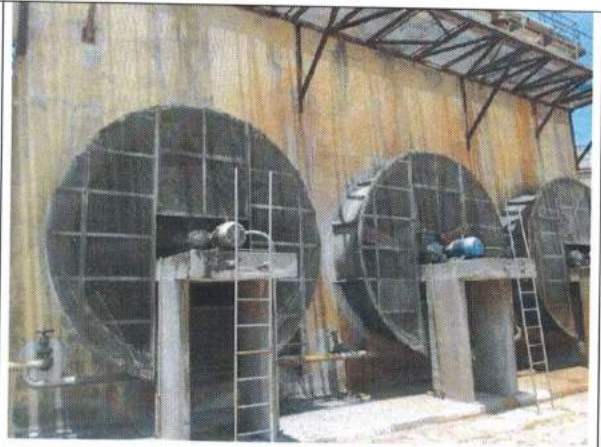
44 – Torre de Resfriamento (Fab. 7)
