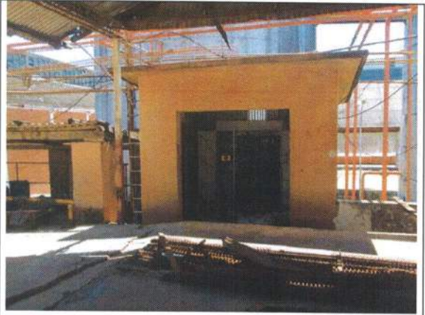
32 – Casa do Painel Elétrico (138)
