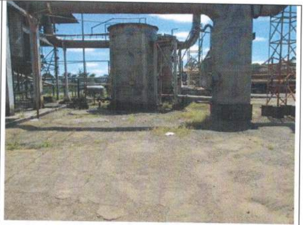
32 – Bases para Tanques (Fab. 5)
