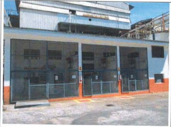
16 – Cabine Elétrica (Fab. 4)
