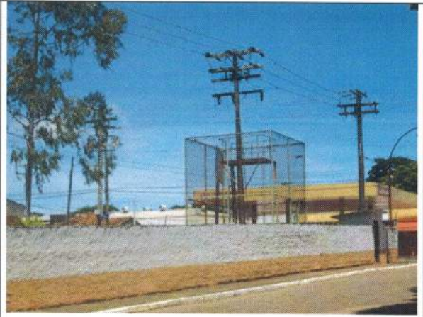
56 – Chave Geral de Alta Tensão (não consid. Construção)
