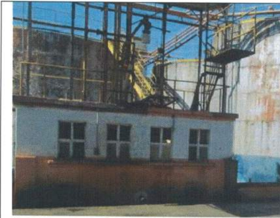
19 – Sala de Bombas (115)
