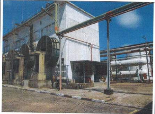
28 – Torre de Resfriamento (Fab. 10)
