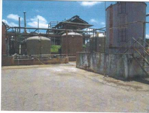
45 – Bases para Tanques (Fab. 7)
