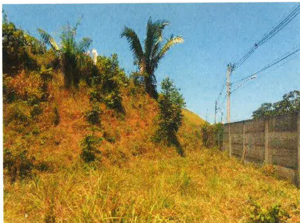
VISTA PARCIAL INTERNA DO IMÓVEL – DETALHE MURO DA AV. 29 DE MARÇO SENTIDO CONDOMÍNIO ALPHAVILE II - MATRICULA 62.893
