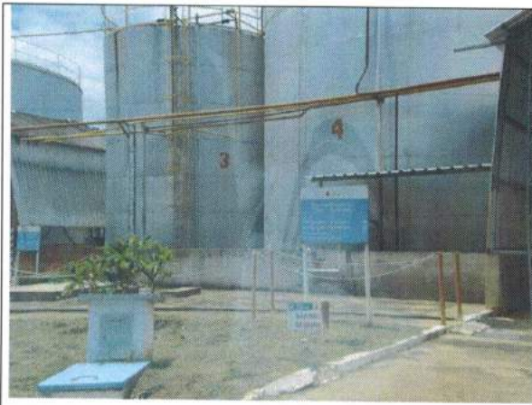
49 – Tanques de óleo
