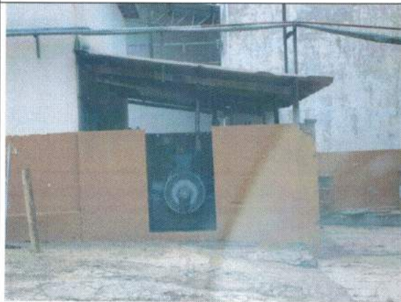
47 – Gerador de Energia
