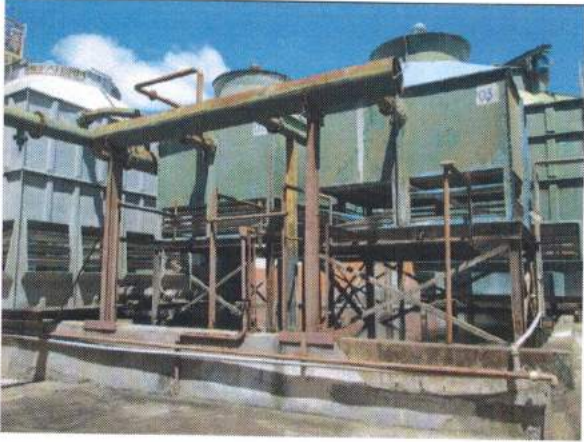
27 – Equipamento de Resfriamento
