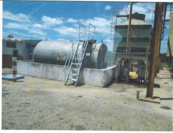
37 – Bacia de Contenção de óleo Diesel
