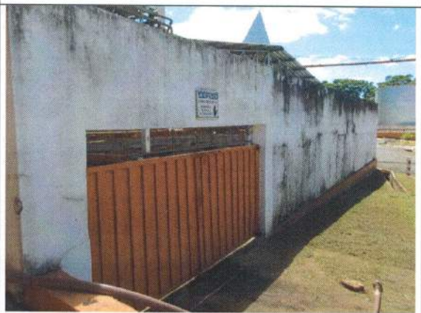
16 – Tanques de Hexano
