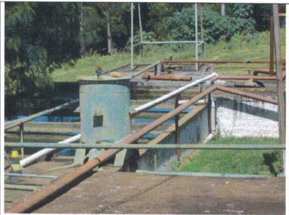
14 – Reserva de Incêndio
