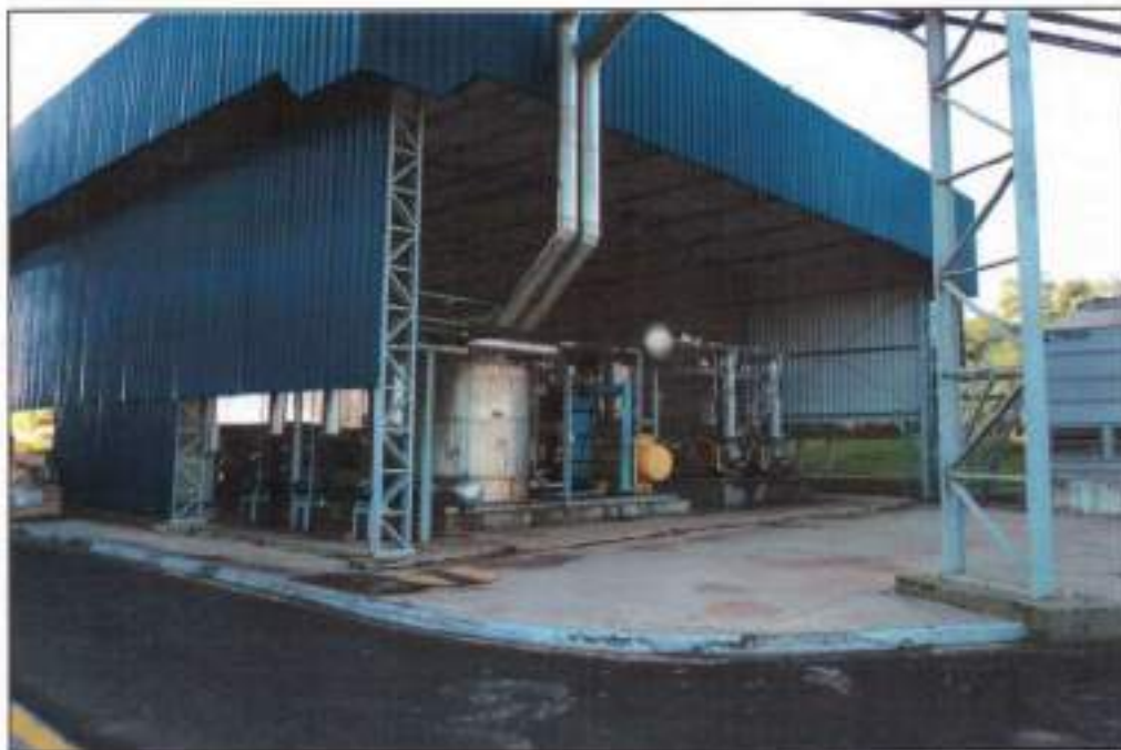
Vista externa – Sistema de refrigeração de água – Cerqueira Cesar/SP
