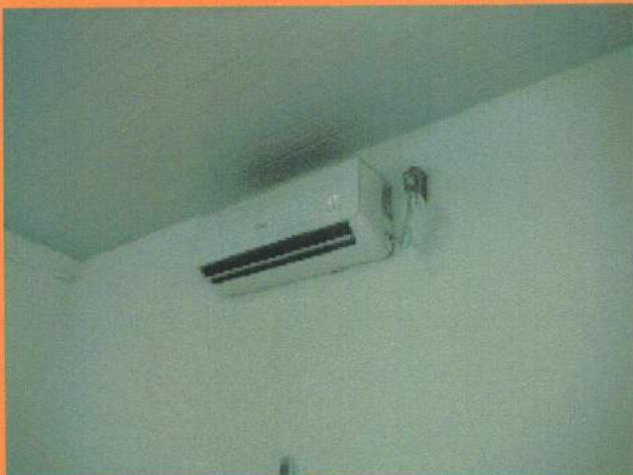
78. Ar condicionado Split
