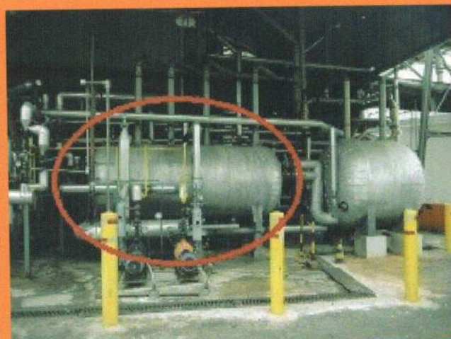
69. Trocador recuperador de calor Engecima
