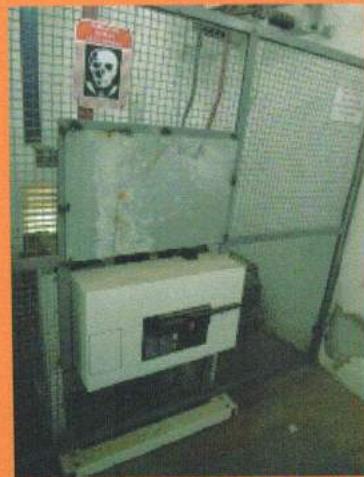
43. Disjuntor Schneider [CABINE ELÉTRICA]
