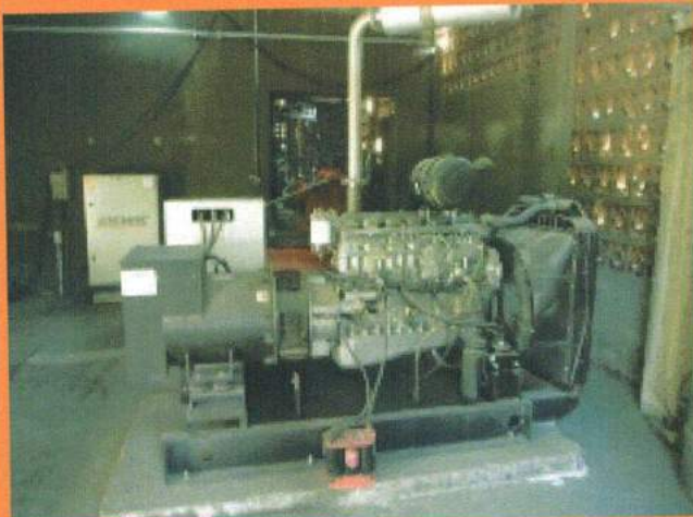
46. Grupo gerador Stemac
