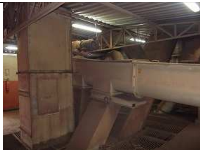
Transportadores de silo (item 13B)
