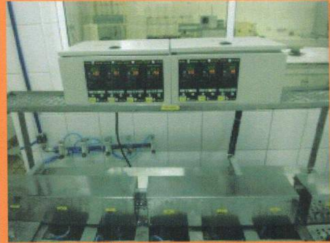
95. Painel elétrico banho maria
