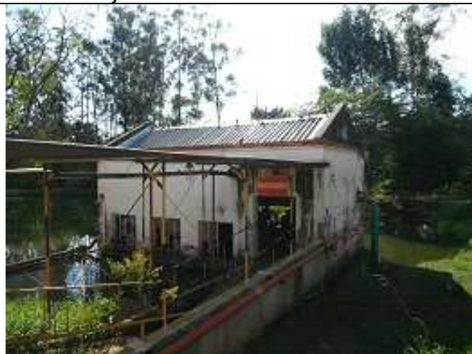
Captação de água de incendio e utilidades
