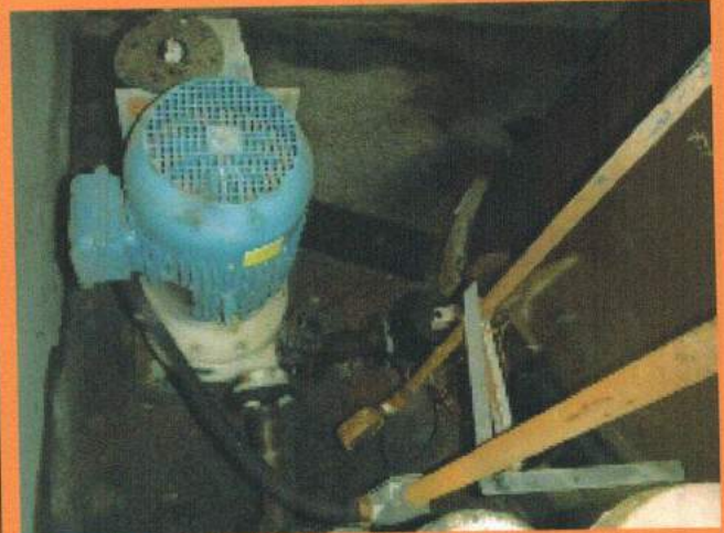
57. Bomba centrífuga Bomax
