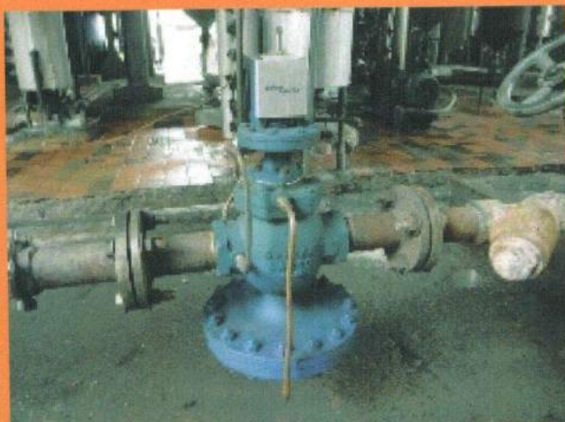
64. Válvula redutora de pressão Sarco
