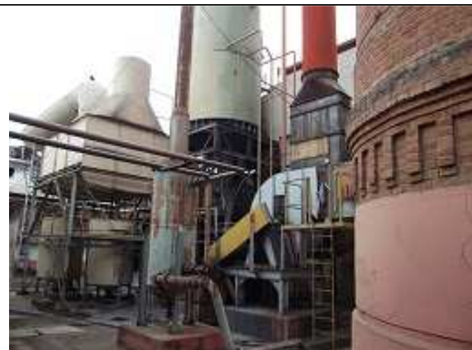
Periféricos das caldeiras
