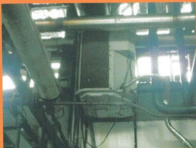
62. Ar condicionado Split
