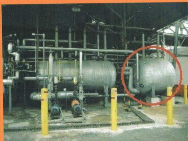
68. Trocador recuperador de calor Engecima
