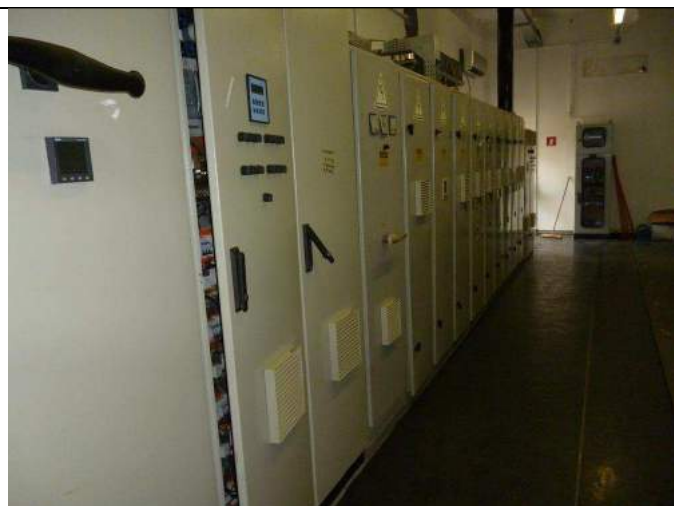
Painéis de controle
