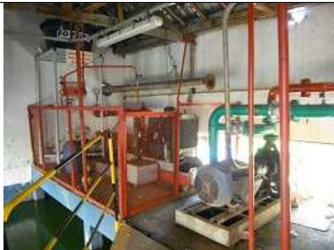
Bombas do sistema de combate a incendio
