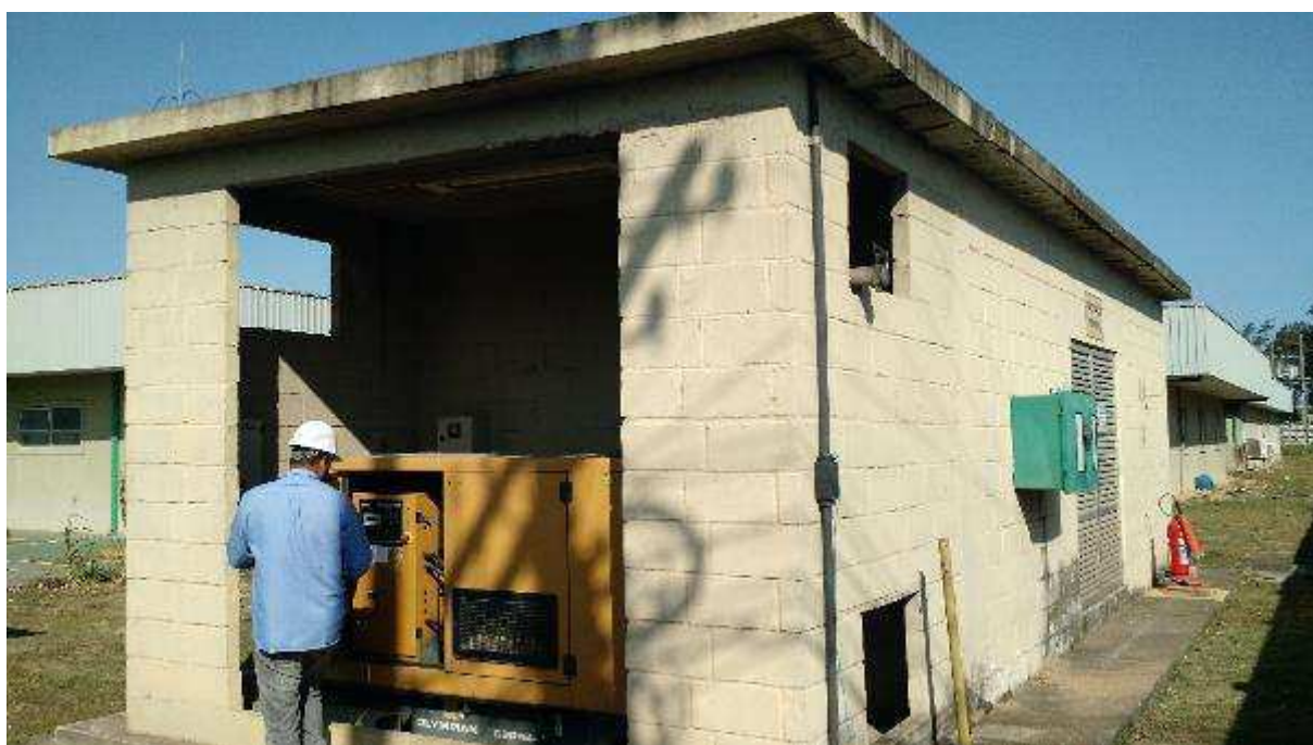
VISTA PARCIAL INTERNA DO IMÓVEL – DETALHE GERADOR
