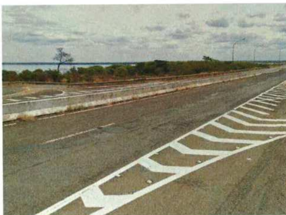
VISTA PARCIAL RODOVIA SP-320 SENTIDO APARECIDA DO TABOADO/MS – DETALHE ACESSO AO TERRENO AVALIANDO
