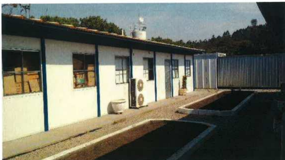
VISTA PARCIAL DA ÁREA ADMINISTRATIVA – DETALHE PARA ACABAMENTO CONSTRUTIVO E ESTADO DE CONSERVAÇÃO DA EDIFICAÇÃO
