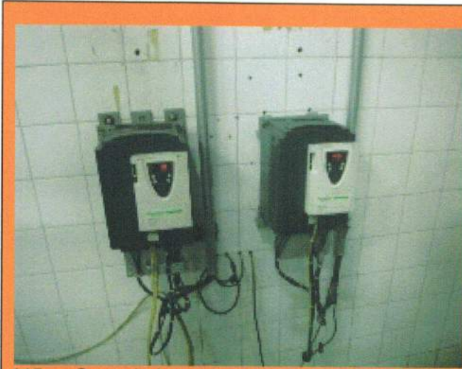
115. Controladores de velocidade Schneider
