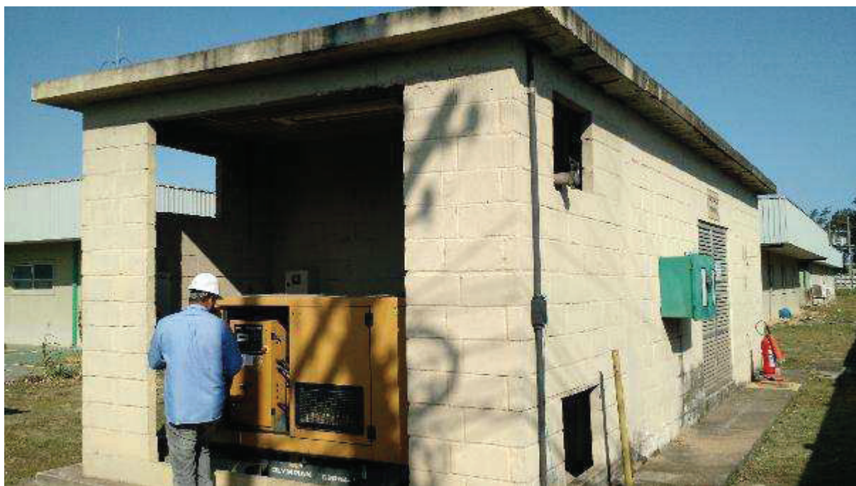
VISTA PARCIAL INTERNA DO IMÓVEL – DETALHE GERADOR
