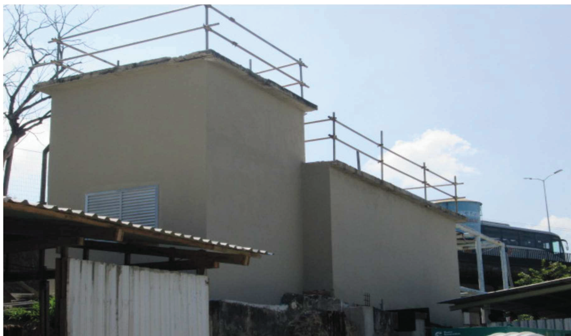
ÁREA 02 - VISTA PARCIAL DO IMÓVEL AVALIANDO – DETALHE PARA SUBSTAÇÃO
