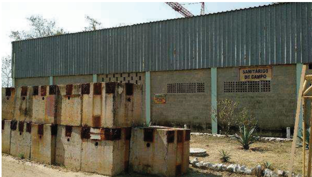
ÁREA 04 - VISTA PACIAL DO IMÓVEL AVALIANDO DETALHE PARA PRÉDIO DE VESTIÁRIO/SANITÁRIO EM CAMPO
