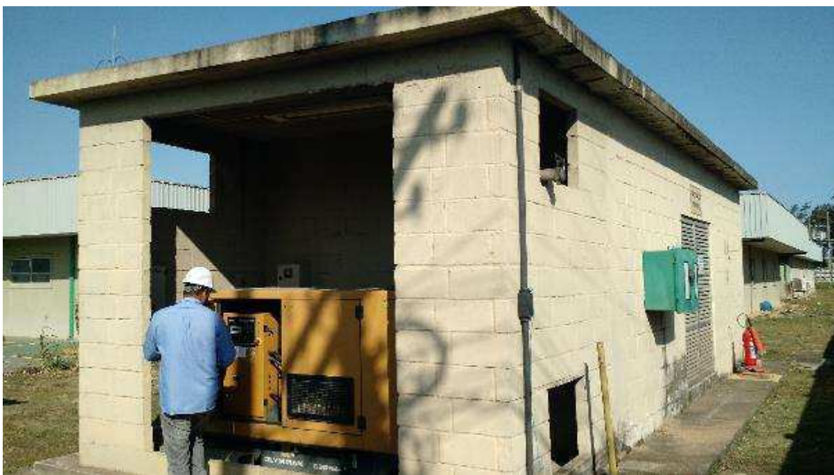
VISTA PARCIAL INTERNA DO IMÓVEL – DETALHE GERADOR
