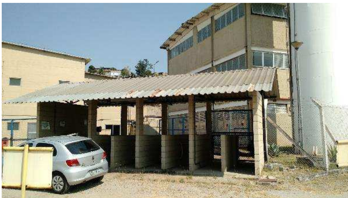
ÁREA 04 – VISTA PARCIAL DO IMÓVEL AVALIANDO – DETALHE PARA PORTARIA DE ACESSO A AREA INDUSTRIAL
