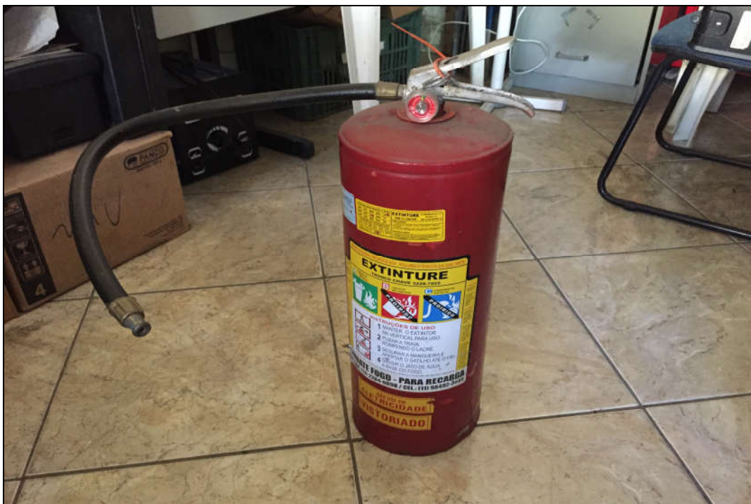
ITEM 1,004 - VISTA DO EXTINTOR DE INCENDIO TIPO: ÁGUA
