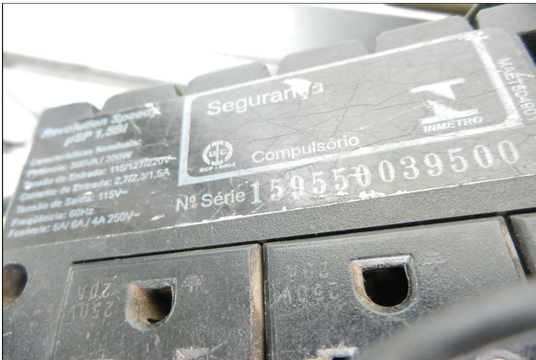
ITEM 2,004 - VISTA DO ESTABILIZADOR DE TENSÃO MARCA: SMS CAP: 300VA/300W SERIE: 159550039500
